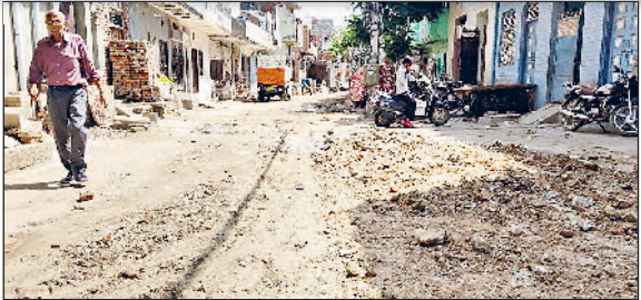
सोनीपत। ज्ञान नगर में अधूरा पड़ा गलियों का निर्माण।
